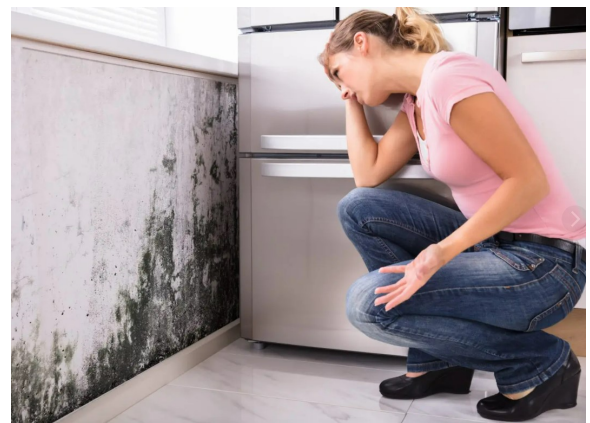
ŞEKİL-2 Duvar üzerinde oluşan küflenmeler
